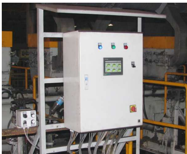
Rys.5. Widok zainstalowanej skrzynki sterowniczej z panelem operatora [3]
