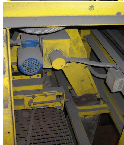
Rys.5. Kusrarka walcowa z obrotowym podzielnikiem próby w automatycznym systemie pobierającym próbkę węgla bezpośrednio z przenośnika taśmowego [7]
