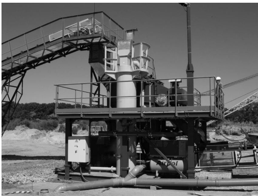
Rys.3. Widok osadzarki K-100 w Żwirowni w Januszkowicach
