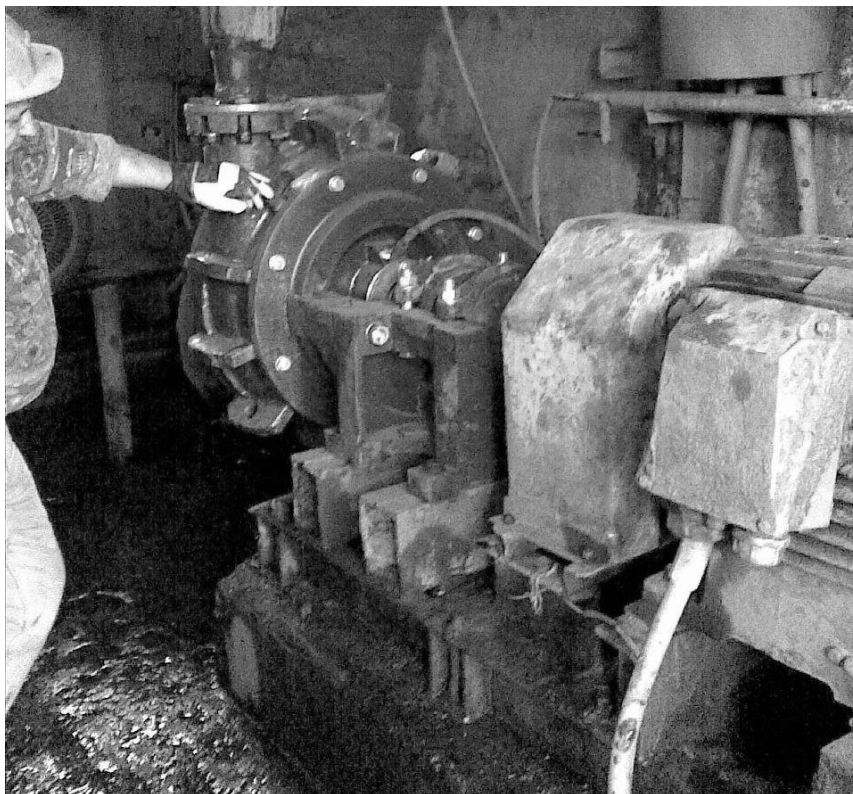
Rys.9. Pompa na stanowisku w KWK „Sośnica”
