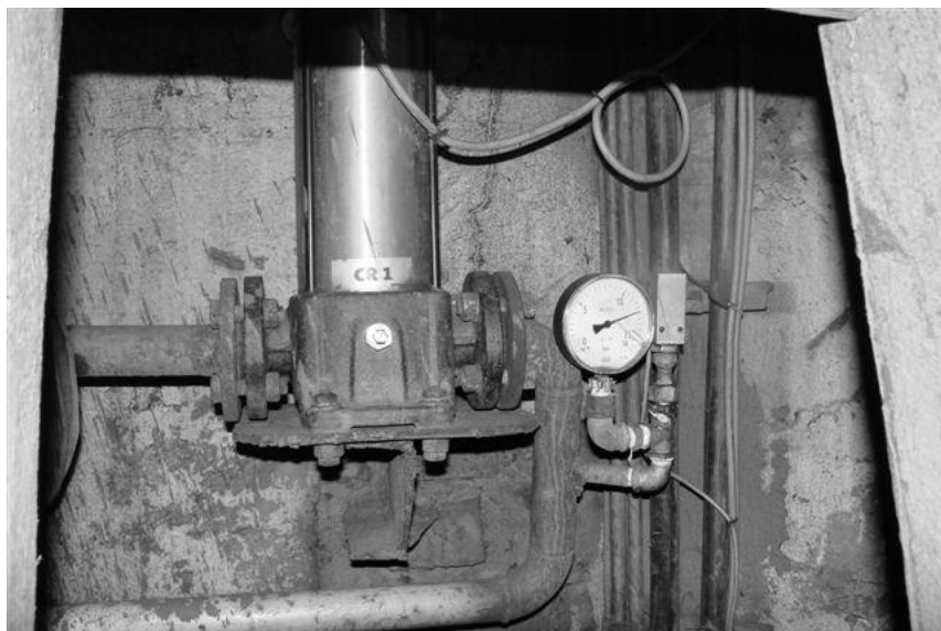
Rys.10. Układ przygotowania wody dławnicowej
