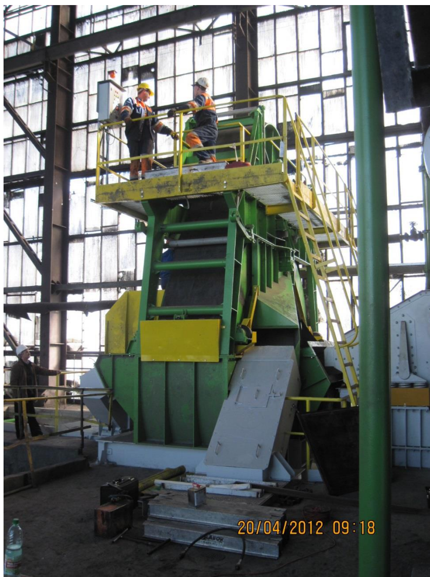
Rys. 3. Miejsce zabudowy wzbogacalnika DISA w zakładzie przeróbczym PG Silesia
