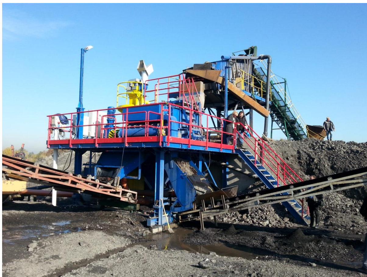
Rys.13. Klasyfikator pulsacyjny K102 zabudowany w instalacji do rekultywacji składowiska pokopalnianego [źródło: dokumentacja fotograficzna ITG KOMAG]
