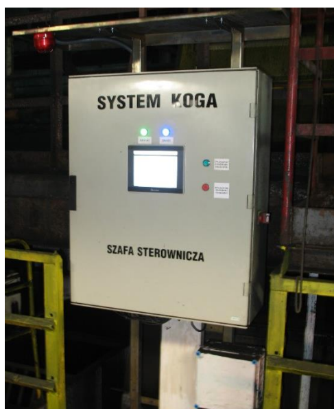
Rys.2. Widok zainstalowanej skrzynki sterowniczej z panelem operatora [źródło: opracowanie własne]
