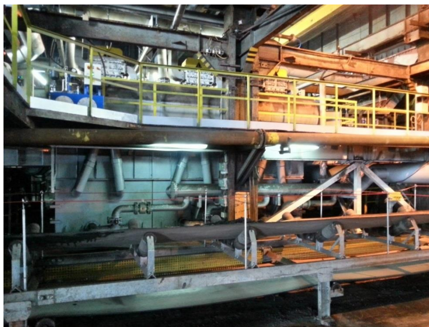
Rys.5. Przenośnik transportujący produkt pośredni (w tle nowa osadzarka) [źródło: dokumentacja fotograficzna ITG KOMAG]
