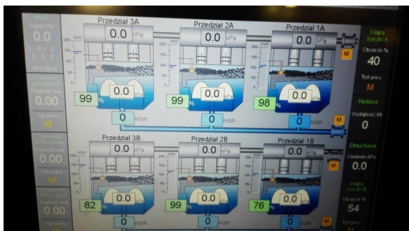
Rys.9. Panel operatorski systemu sterowania KOGASTER [źródło: dokumentacja fotograficzna ITG KOMAG]
