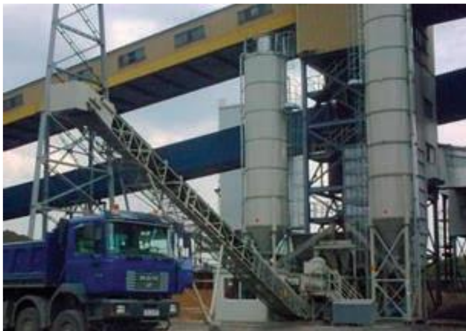
Rys. 8. Instalacja do produkcji mieszanek kruszywo-popiołowych w ZG „Sobieski”
