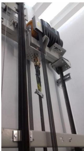
Rys. 2. Obiekt pomiarowy – liny nośne dźwigu osobowego
